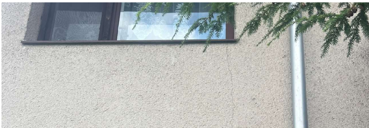
Trhlina v parapetu 2.NP
