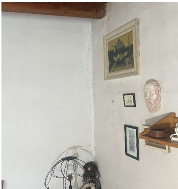
Trhlina mezi stěnami v rohu
