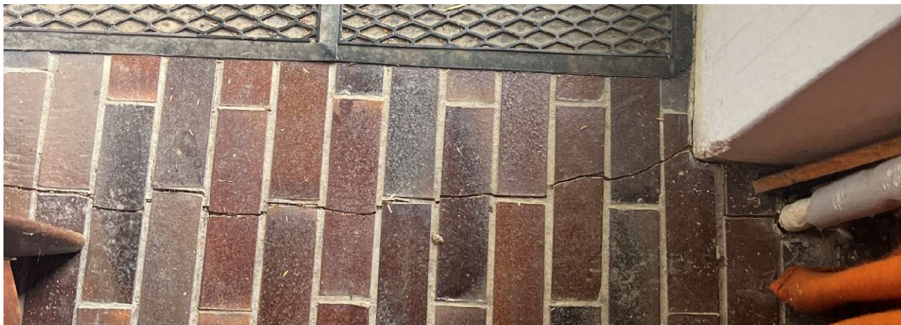
Trhliny v podlaze 1.NP
