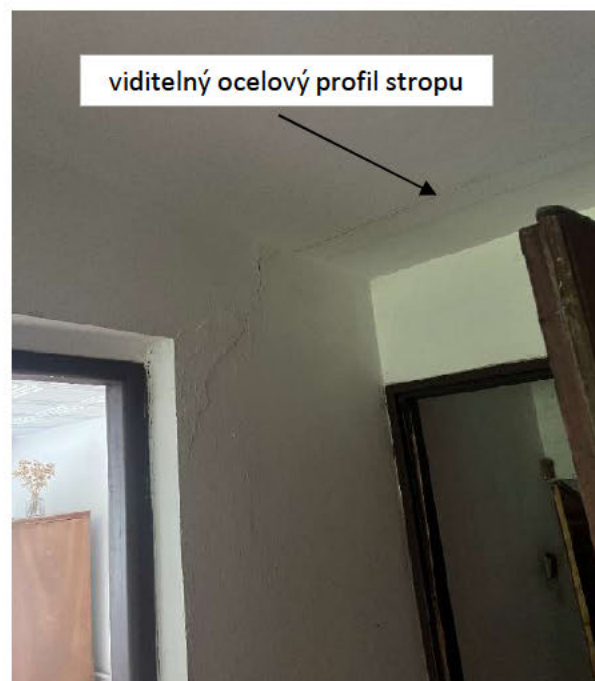
Trhlina v nosné stěně 1.NP - b
