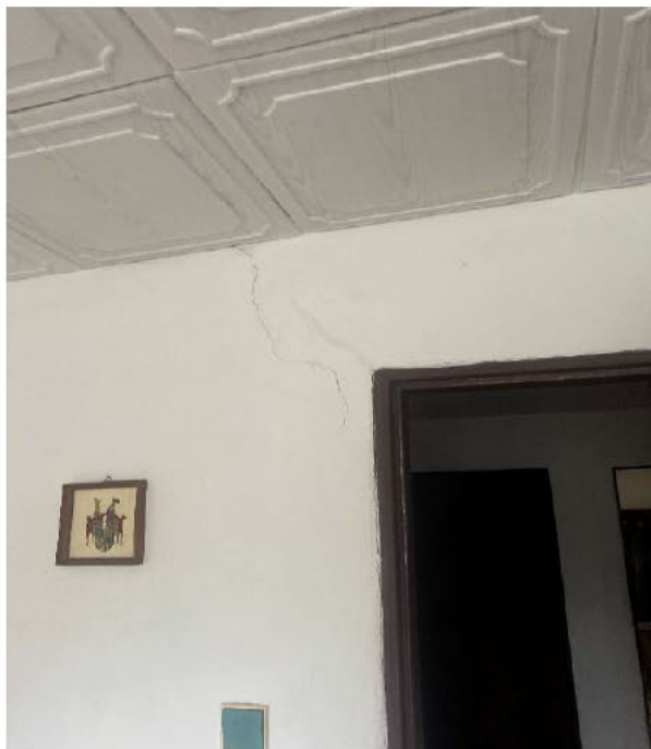
Trhlina v nosné stěně 1.NP - a
