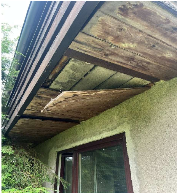
Odpadající záklop balkonu
