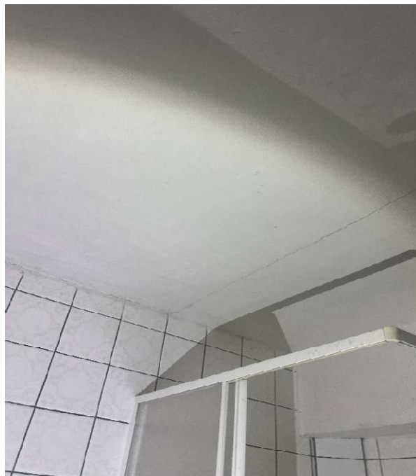
Trhliny ve stropní konstrukci nad 1.NP
