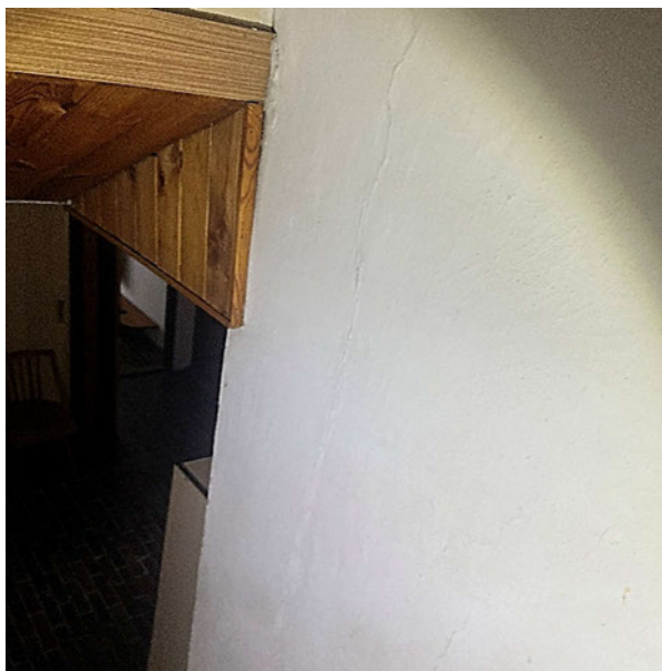
Trhlina ve stěně u komína
