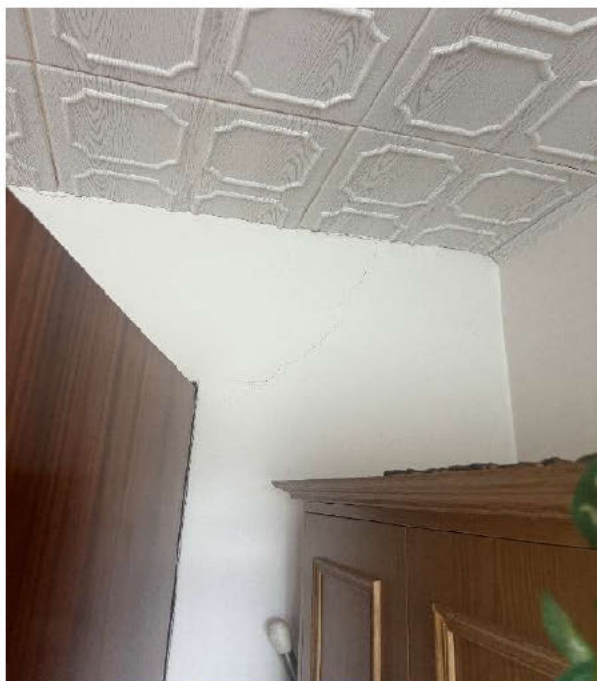
Trhlina ve stěně
