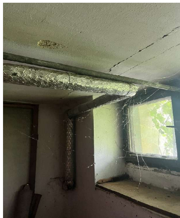
Trhliny ve stropní konstrukci nad 1.NP
