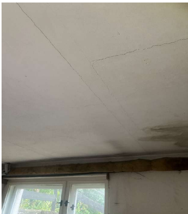
Trhliny ve stropní konstrukci nad 1.NP - garáž
