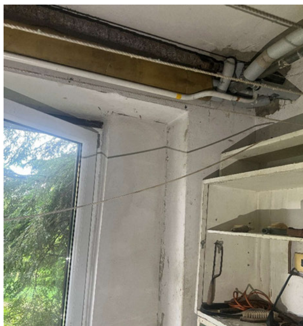
Trhlina mezi stěnami bývalé garáže
