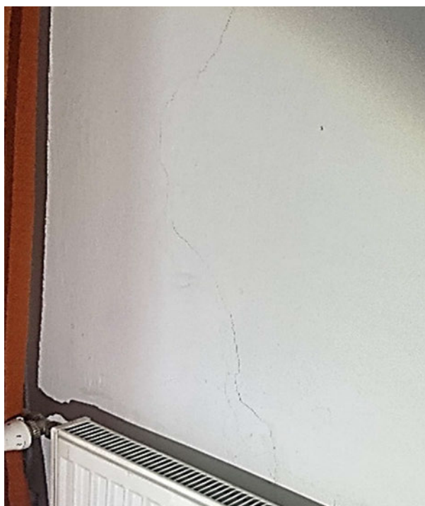
Trhlina ve stěně u vstupu do objektu
