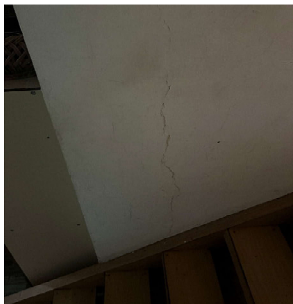
Trhlina ve stěně u komína
