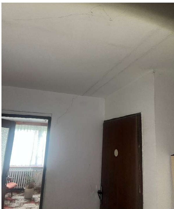
Trhliny ve stropní konstrukci nad 1.NP
